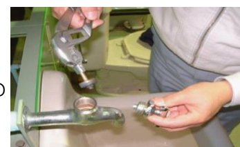
給水設備説明
