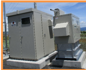
高圧受電設備・非常用発電機
